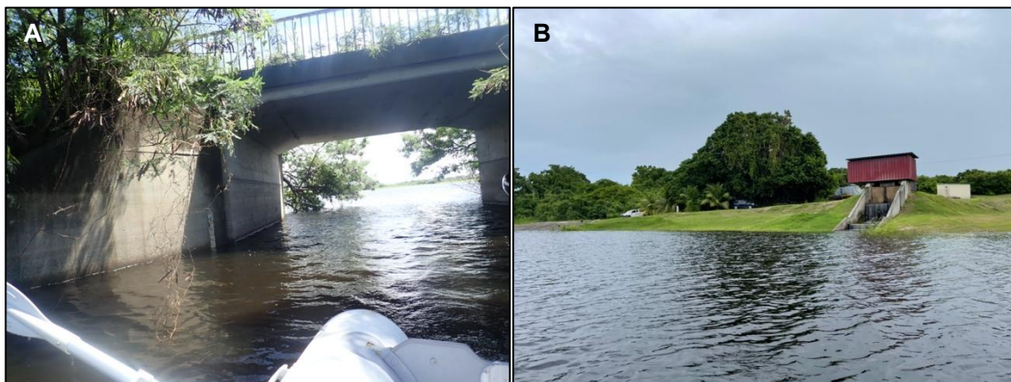
Figure 6. Illustrations d'altérations de berge sur Gaschet : (A) pont routier et (B) Compactage
