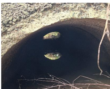
Buse obstruée à 80% en aval
