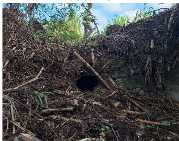
Sortie aval de la buse partiellement obstruée
