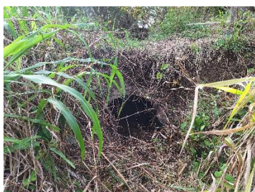
Sortie amont de buse partiellement obstruée
