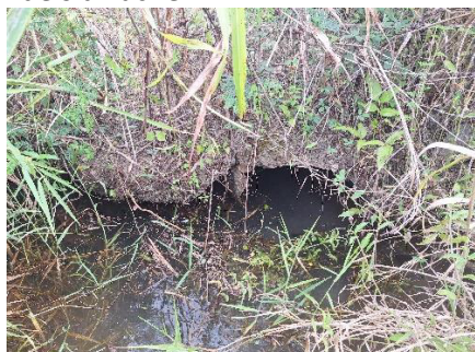
Vue amont : anse métallique décollée
