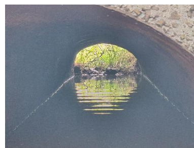
Buse obstruée à 50% en aval
