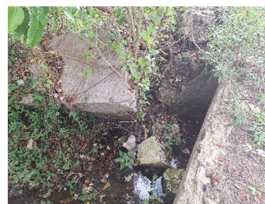
Mur effondré en rive droite
